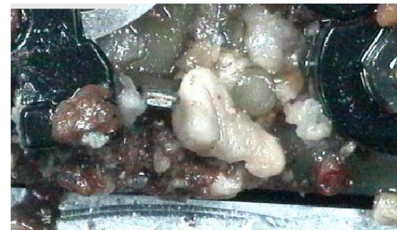
スラッジが発生し詰まってしまったインジェクターポンプ
