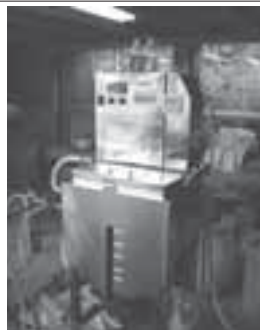
写真 125 B.D.F.製造装置 (50L 型乾式アルカリ触媒 法・吸着剤式精製法による B.D.F.製造・精製装置)
