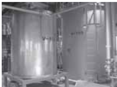
写真 112 静置槽 (左) と廃食用油 (原料) タンク (右)
