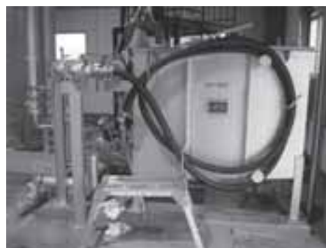
写真 111 廃食用油受け入れ槽
