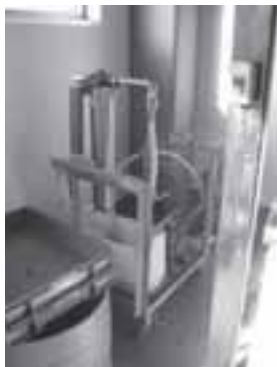
写真 118 遠心分離機に代わって使用される1ミクロンフィルター
