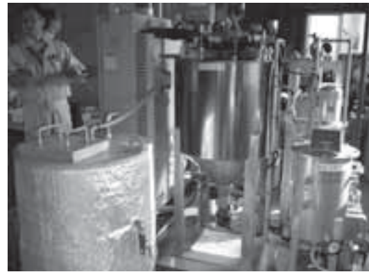
写真 120 (右から) 触媒溶解タンク、フ ラッシュ蒸留タンク、反応タンク (← 原料タンク・触媒溶解タンク)、運転 管理パネル、原料タンク
