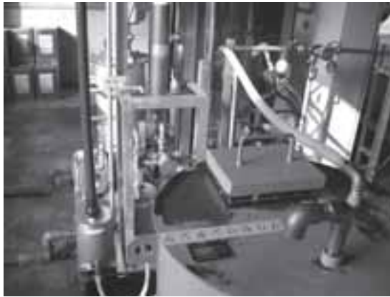
写真 121 グリセリンタンク (←反応タンクに おける二次分離後)、(奥に) コンデンサ ーと反応タンク
