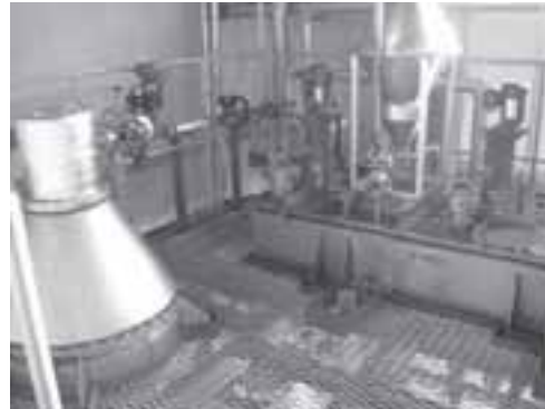
写真 115 第2セパレータ(グリセリン分離槽)と洗浄槽(ラインミキサーによる温水混合後、複槽式、下部より排水、周辺にラインミキサーが見える)
