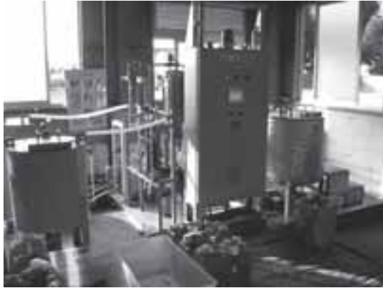
写真 119 (右から) 原料タンク、運転管理 パネル、反応タンク、コンデンサー、 製品タンク (奥にグリセリンタンク) (乾式アルカリ触媒法・化学的処理式精製法)
