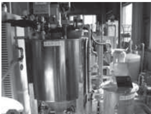
写真 123 (左から) 運転管理パネル、反応タン ク、コンデンサー、触媒溶解タンク、 冷却水循環タンク
