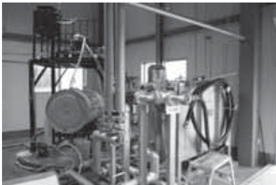
写真 116 B.D.F.製造最終工程(左奥:遠心分離機、その下:製品タンク)
