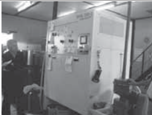
写真 129 200L 型乾式蒸留法 B.D.F. 製造装置
