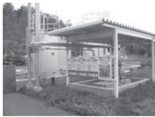
写真 140 B.D.F.製造施設に併設された外 部貯留タンクとその右側に給 油ステーション
