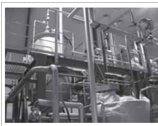
写真 76 脱ガム（リン脂質）装置
