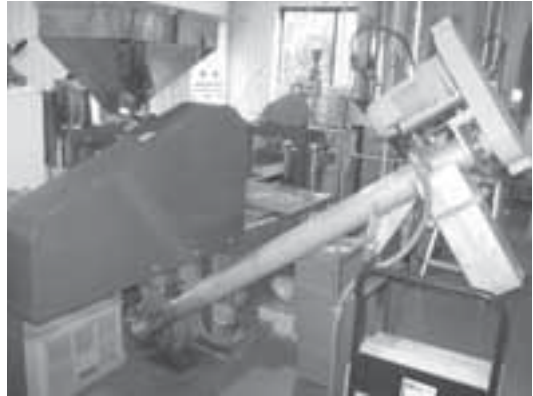
写真 55 搾り粕搬送機
